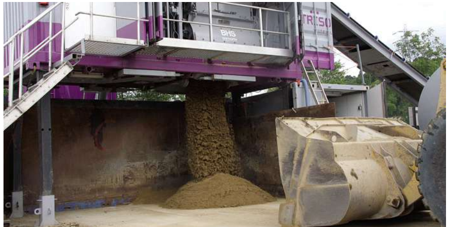
Der Doppelwellen-Chargenmischer im Inneren des Containers ist das Herz der Mischanlage.
