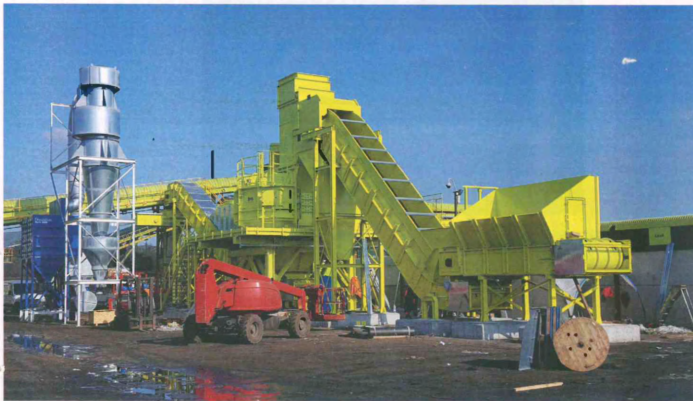
Die Recyclinganlage im Vereinigten Königreich für Automotive Shredder Residue sowie Elektro- und Elektronikschrott befindet sich auf dem Bild noch im Aufbau. Sie wurde von BHS-Sonthofen konzipiert und implementiert.
